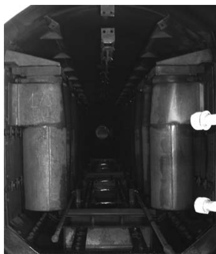
Blick in die Kesselanlage
